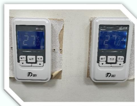
空調採用恆溫裝置
